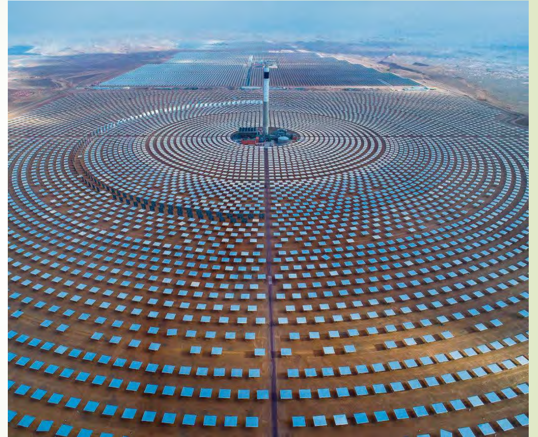
Le Complexe solaire Noor de Ouarzazate I II III IV
